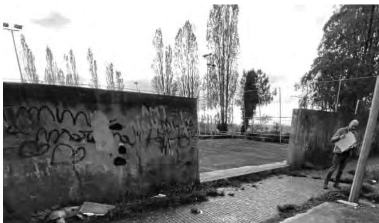
Figura 102: Estado inicial do muro Fonte: L3P/UA
